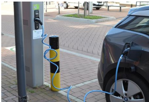
Abb. 4.6-1 E-Ladesäule während des Ladevorgangs 21
